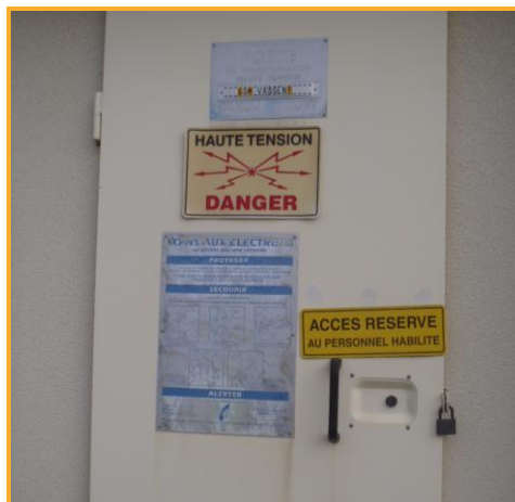
Armoires électriques sur l'installation de traitement de Vasseny
